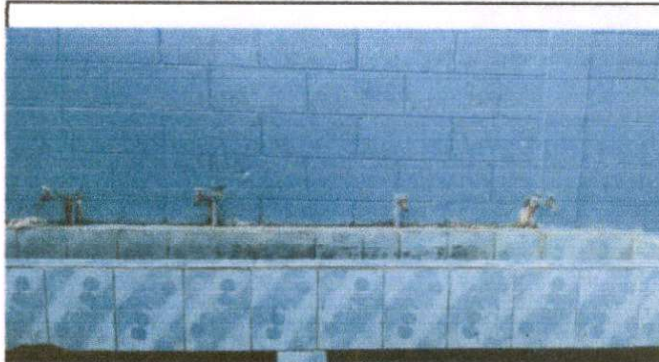
Foto 6: chorros en mal estado
